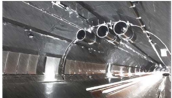
Imagen 13. Ventiladores en túnel
