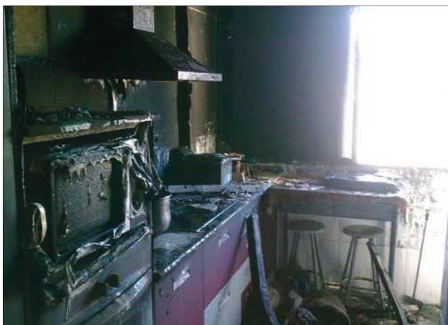
Imagen 35. Incendio de contenido. Estructura de obra de fábrica y forjados de hormigón
