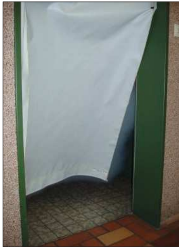
Imagen 173: La cortina de bloqueo de humo succionada hacia el interior indica que el incendio tiene una apertura al exterior y que se ha establecido un flujo de gases unidireccional
