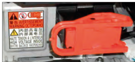
Imagen 128. Conector de servicio + fusible para abrir el circuito de la batería
