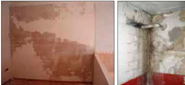
De obra Accidentales Imagen 431. Humedades de origen antrópico
