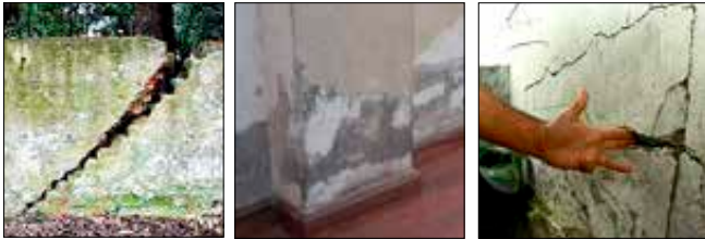
Imagen 428. Grietas y humedades
