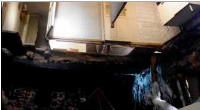
Imagen 455. Muros de fábrica en pie tras colapso de forjado superior
