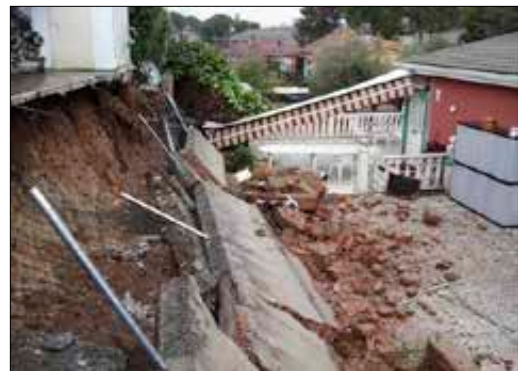
Imagen 440. Lesiones por movimientos del terreno
