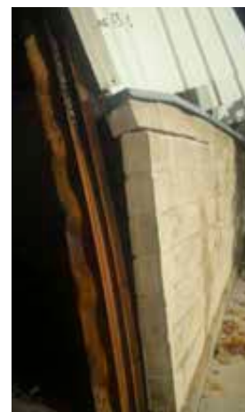
Imagen 450. Arrastre de muro de bloque de hormigón por estructura de acero afectada por incendio
