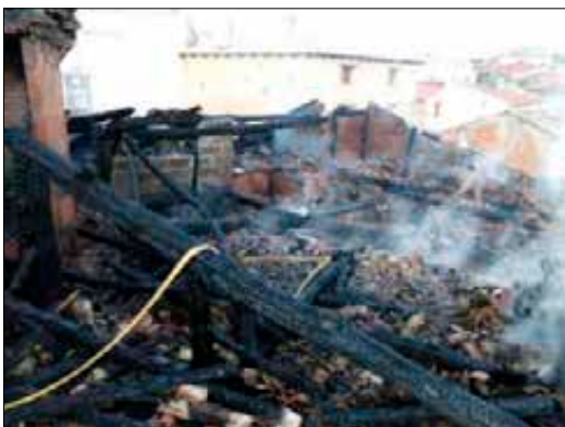
Imagen 457. Estructura de fábrica tras incendio
