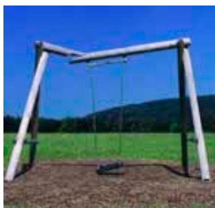
Imagen 190. Rotura de empotramiento
