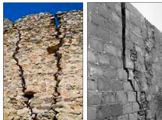
Gruesos excesivos mortero Ampliación muro, con incorrecta conexión
