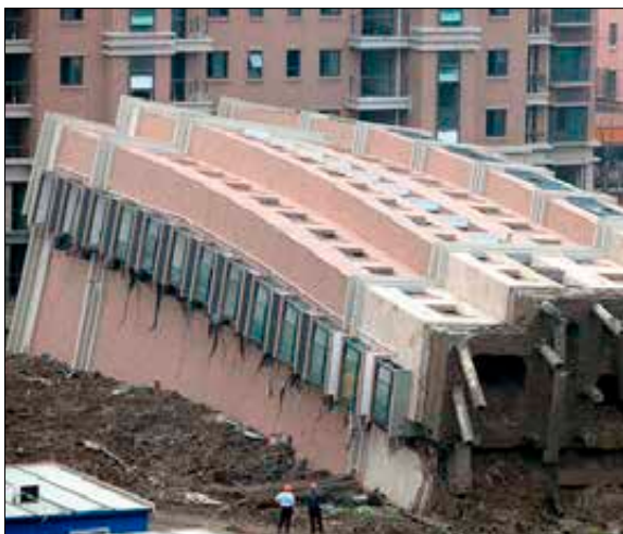
Imagen 676. Efectos sobre las edificaciones
