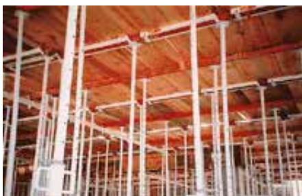
Guías de encofrados horizontales
