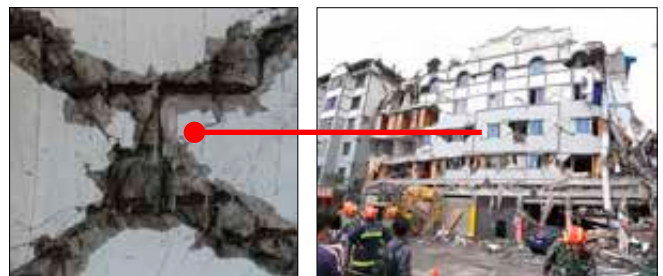
Imagen 678. Grietas por oscilaciones horizontales
