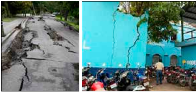
Imagen 627. Grietas por empuje y deshidratación debidos a raíces
