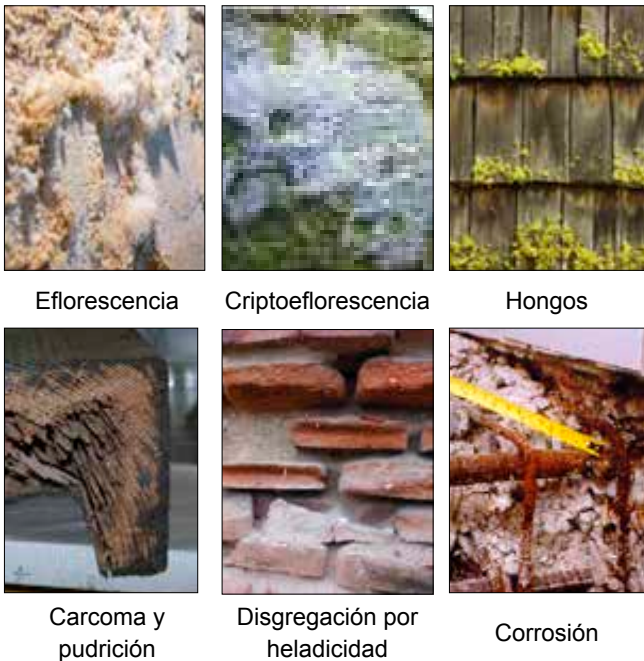
Imagen 610. Patologías vinculadas a la acción del agua
