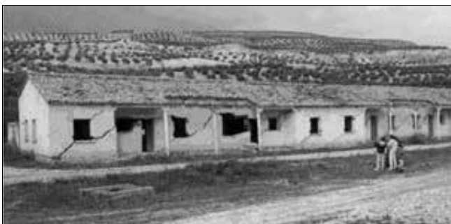
Imagen 623. Grietas por arcillas expansivas en edificaciones reales
