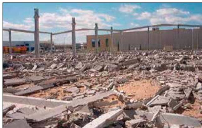
Imagen 666. Colapso de estructura prefabricada
