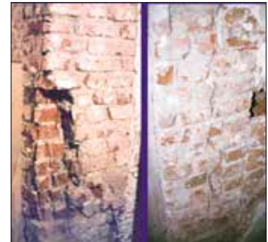
Grietas y abombamientos
