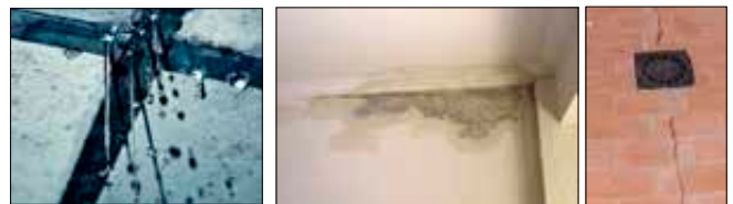
Imagen 611. Humedades de filtración
