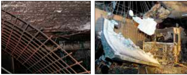
Imagen 668. Colapso por adherencia
