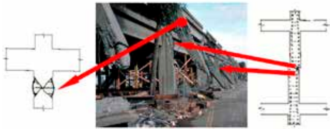
Imagen 683. Grietas en pilares
