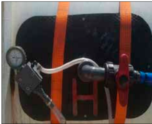
Imagen 256. Taponamiento de escape en tubería
