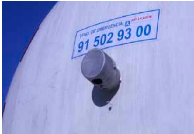
Imagen 137. Válvula de seguridad de cisterna de nitrógeno
