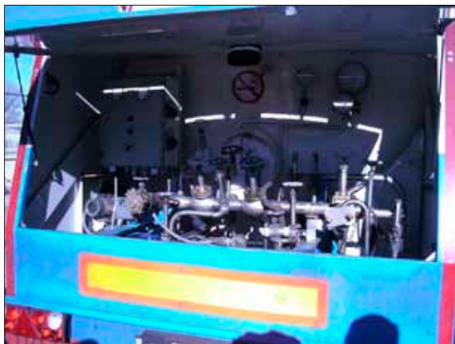
Imagen 162. Armario trasero cisterna nitrógeno
