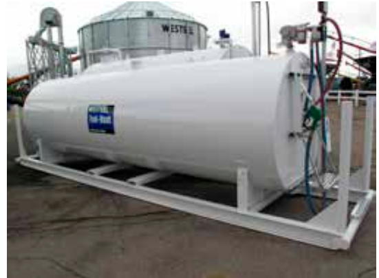
Imagen 194. Depósito fijo de gas
